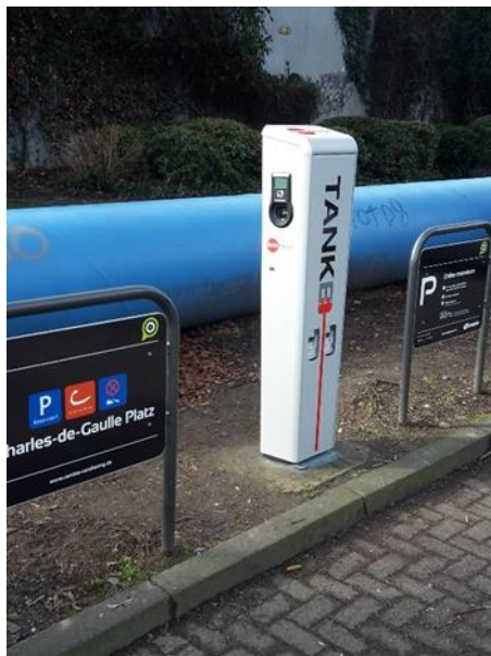
Figure 205 Charles de Gaulle platz charging station (M11.1 Cologne)
